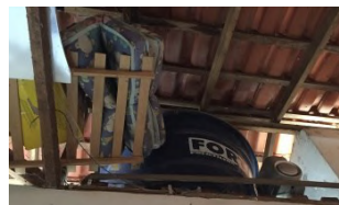
Objetos armazenados na estrutura da cobertura.
