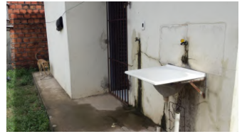
Instalações hidráulicas com necessidade de reparos.
