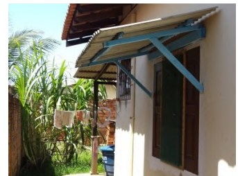
Figura 4—Troca de esquadria e construção de beiral para evitar insolação direta no ambiente feita pela moradora. Foto: Acervo ATAU, 2017.
