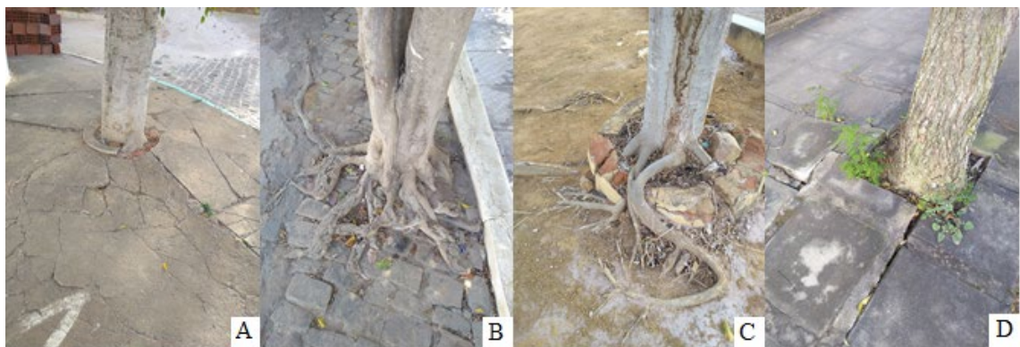
Figura 3: Raízes que danificaram o calçamento.
